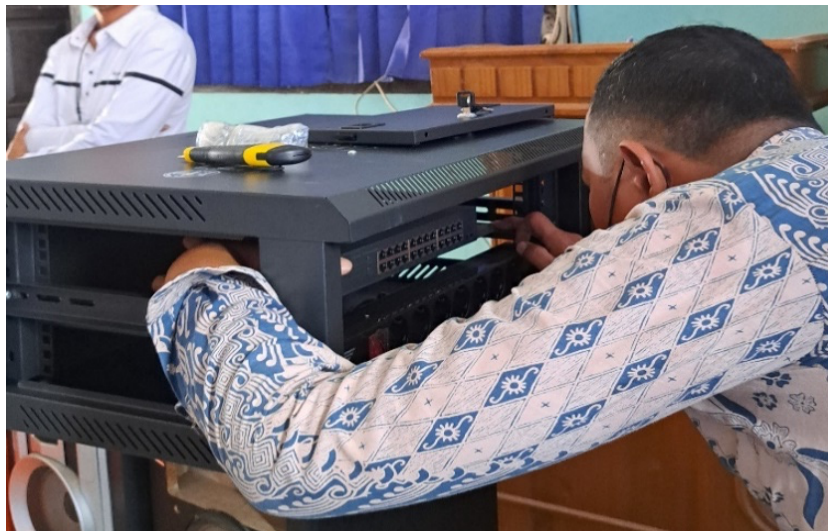
Gambar 8. Instalasi Peralatan Jaringan
